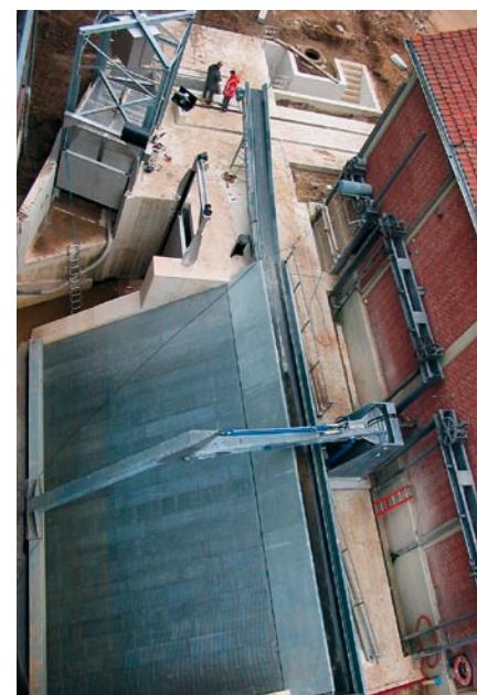
Bild 5: 10-mm-Rechen an der Wasserkraftanlage Roermond/Niederland (Ausbaudurchfluss 16 m 3 /s, Baujahr 2008)
