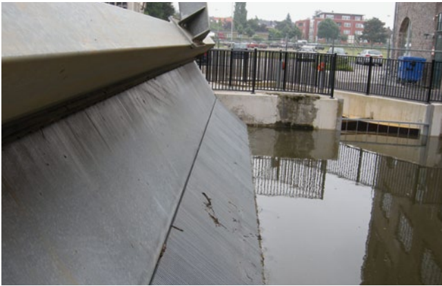
Bild 2: 10-mm-Rechen im Betrieb, Blick auf den oberflächennahen Bypass
