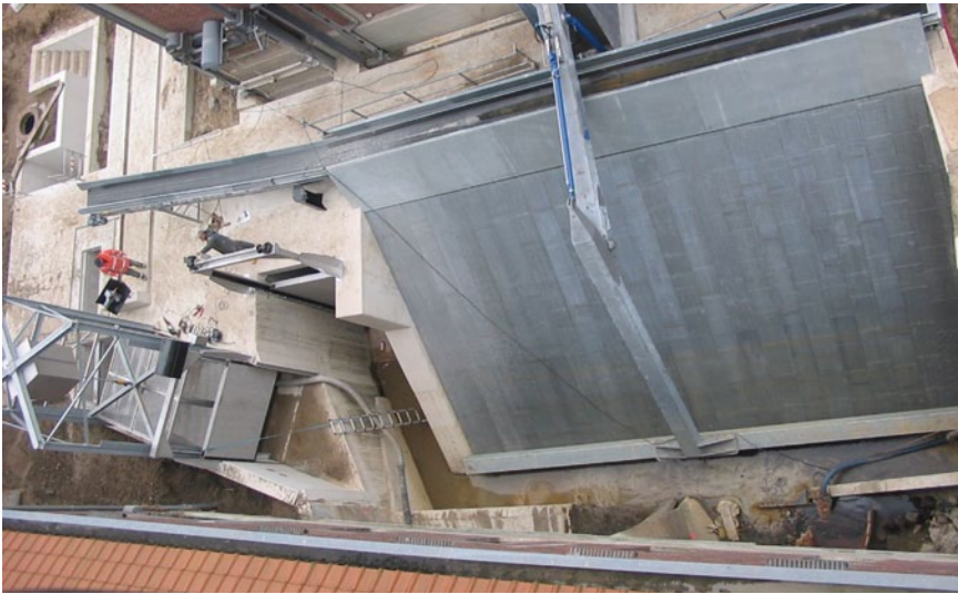
Bild 4: 10-mm-Rechen mit Rechenreinigungsmaschine und Förderband für das Rechengut während der Montage: links befinden sich die stationäre Reusenanlage und der Ausstieg der Fischaufstiegsanlage, dazwischen liegt der Leerschuss, in dem der sohlennahe Bypass angeordnet ist
