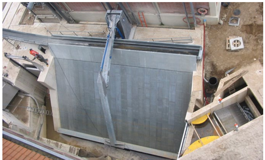
Bild 5: Rechts neben dem Rechen zweigt der oberflächennahe Bypass ab, in der Abstiegschamber befindet sich der Tiroler Rechen zur Ausleitung der Fische während des Monitorings
