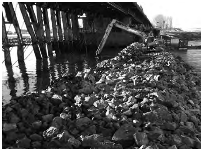
Bild 6: Erste Schutzmaßnahmen an der beschädigten Wehranlage in Grave (Quelle: Rijkswaterstaat)
