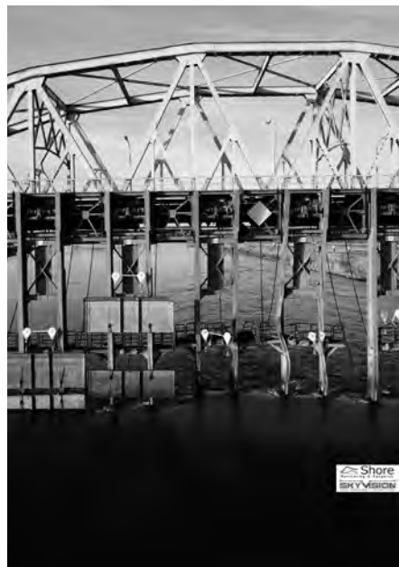
Bild 1: Defekte Wehrverschlüsse nach der Wehrhavarie in Grave (Quelle: Rijkswaterstaat)
