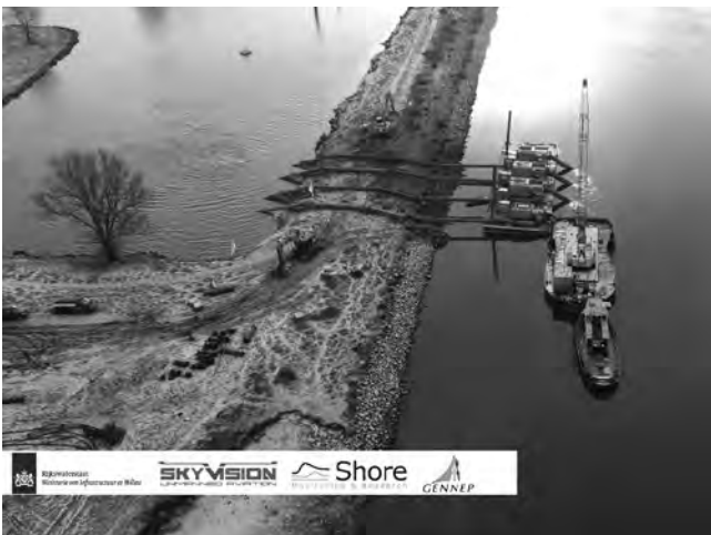
Bild 5: Pumpenanlage am Hafenbecken von Gennep (Quelle: Rijkswaterstaat)
